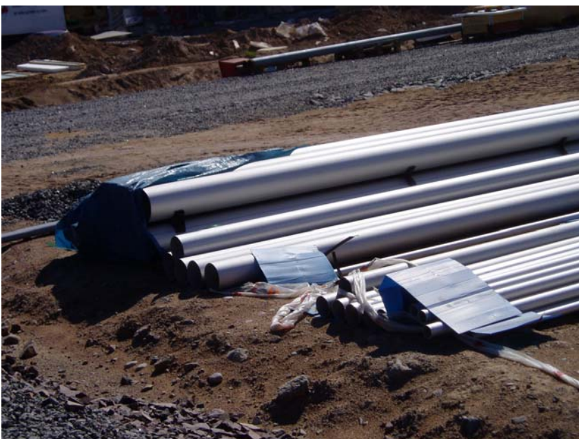
Figur 3. Ny-leverede rør, som opbevares ukorrekt på site.
