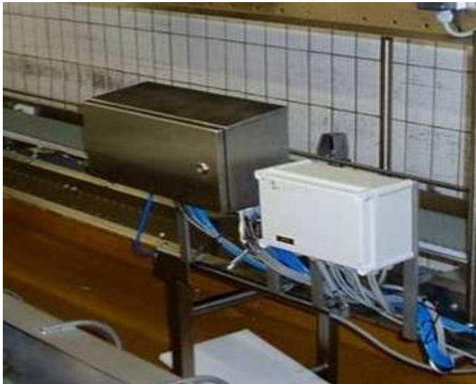
Billede 4 Meget mangelfuldt hygiejnisk design. Bemærk vandret overflade og mange ledninger i bundter.
