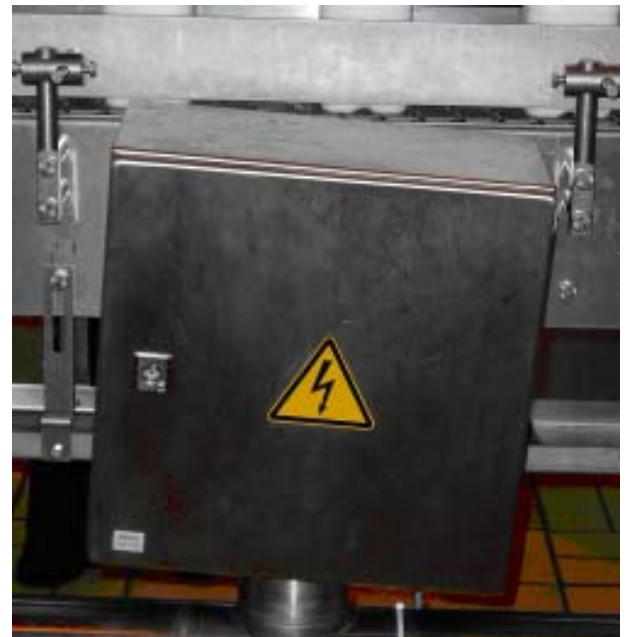
Billede 5 Forbedring af det hygiejniske design forsøgt løst ved at sætte elskabet på skrå. Dog er der alvorlige problemer, idet elledningerne er samlede i lukkede rør, der meget vanskeligt kan rengøres.
